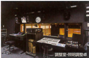
調整室・照明調整卓
